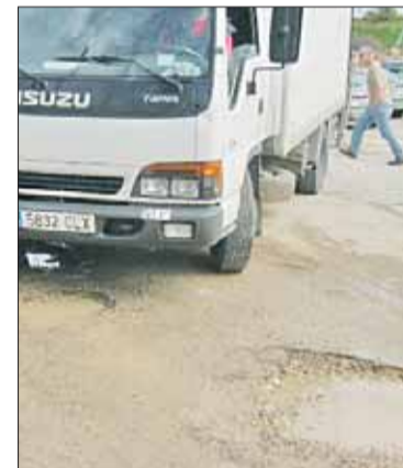
Una de los caminos con socavones.
